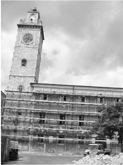
図7 使用不能となった市役所庁舎
