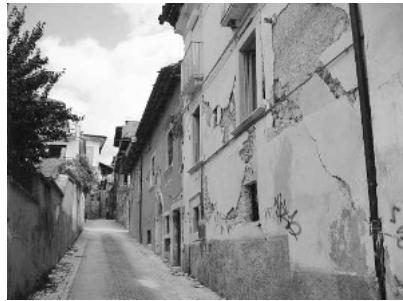
図10 被害を受けた住宅街
