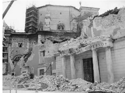
図6 崩壊した県庁舎旧館
