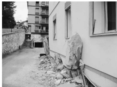
図2 1階駐車場部分がつぶれたマンション
