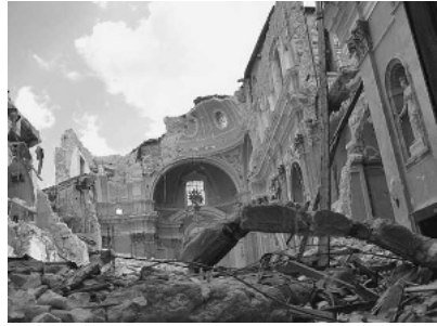
図8 崩壊した教会
