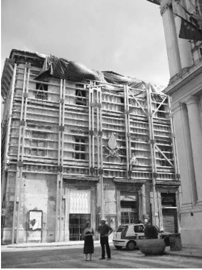
図13 崩壊防止の外枠がはめられた消防署
