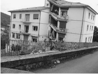
図3 1階駐車場部分がつぶれたマンション
